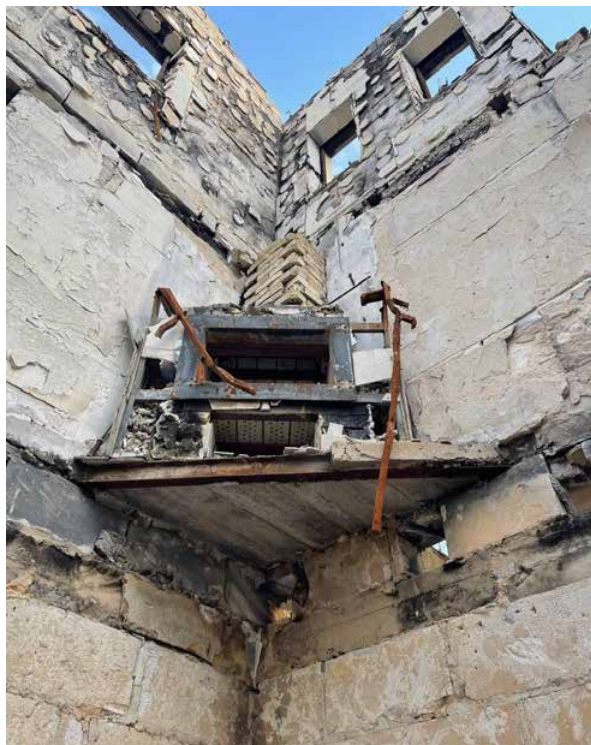
Стіни зруйнованого будинку мешканки Ірпеня Ольги Ракул. Вул. Багірова, 28/1
