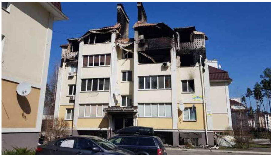
Житловий будинок в Ірпені по вул. Університетська, 2К. Після деокупації Ірпеня 41
